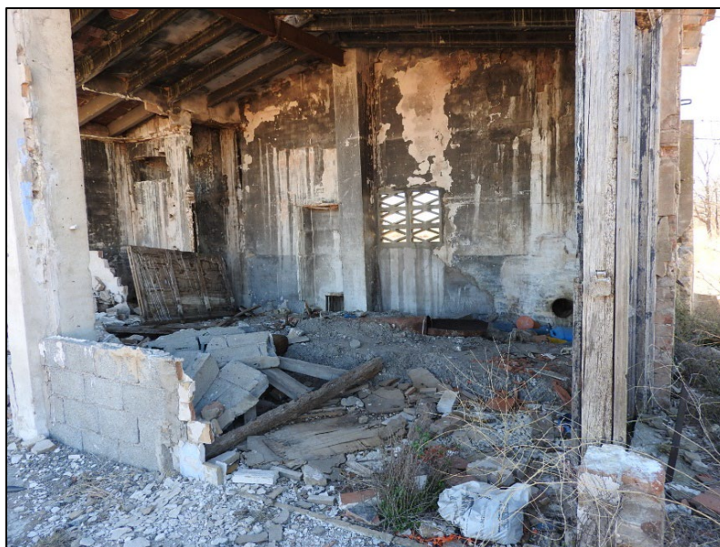
Figura 213. Deterioro Motor de L'Arrif
