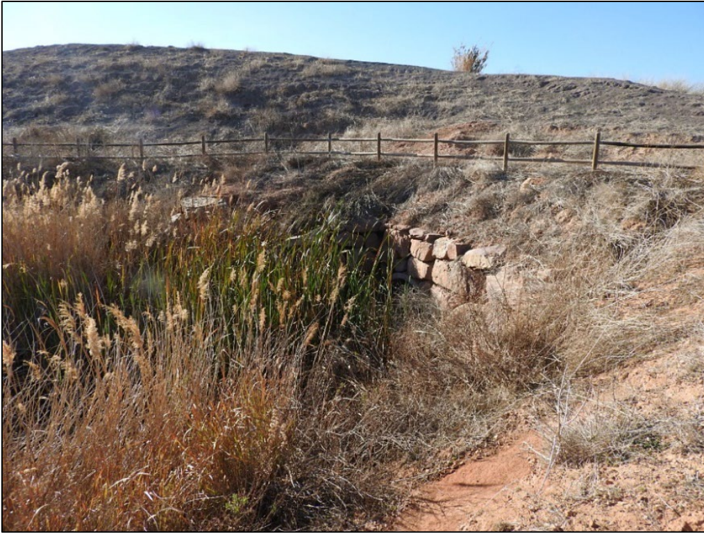
Figura 116. Punto de entrada aguas pluviales
